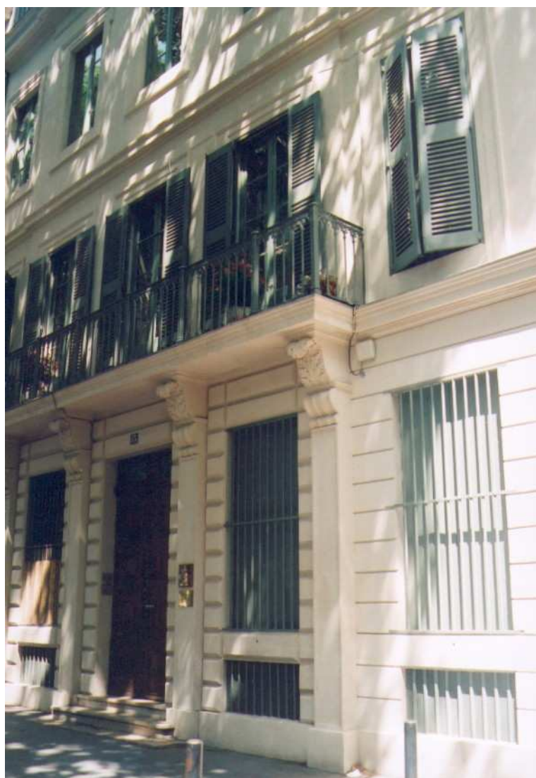
Rez-de-chaussée et 1 er étage, au niveau de la partie centrale de la façade sur le boulevard
